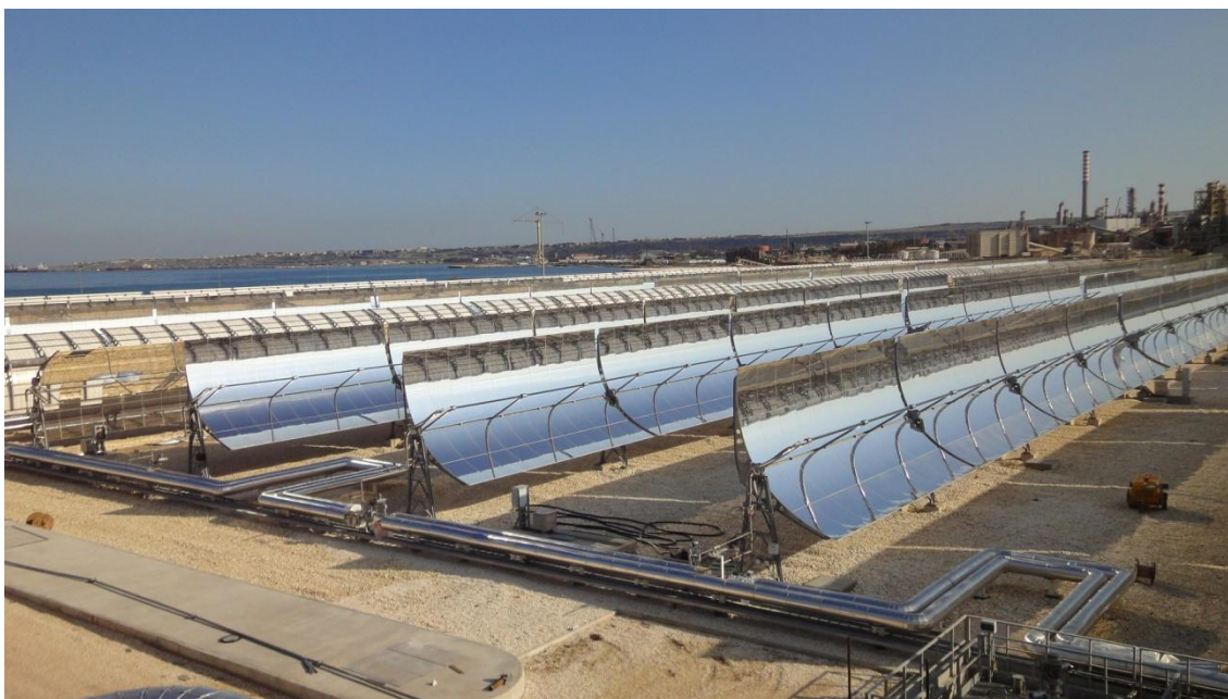
Figura 2 – Impianto solare Archimede
