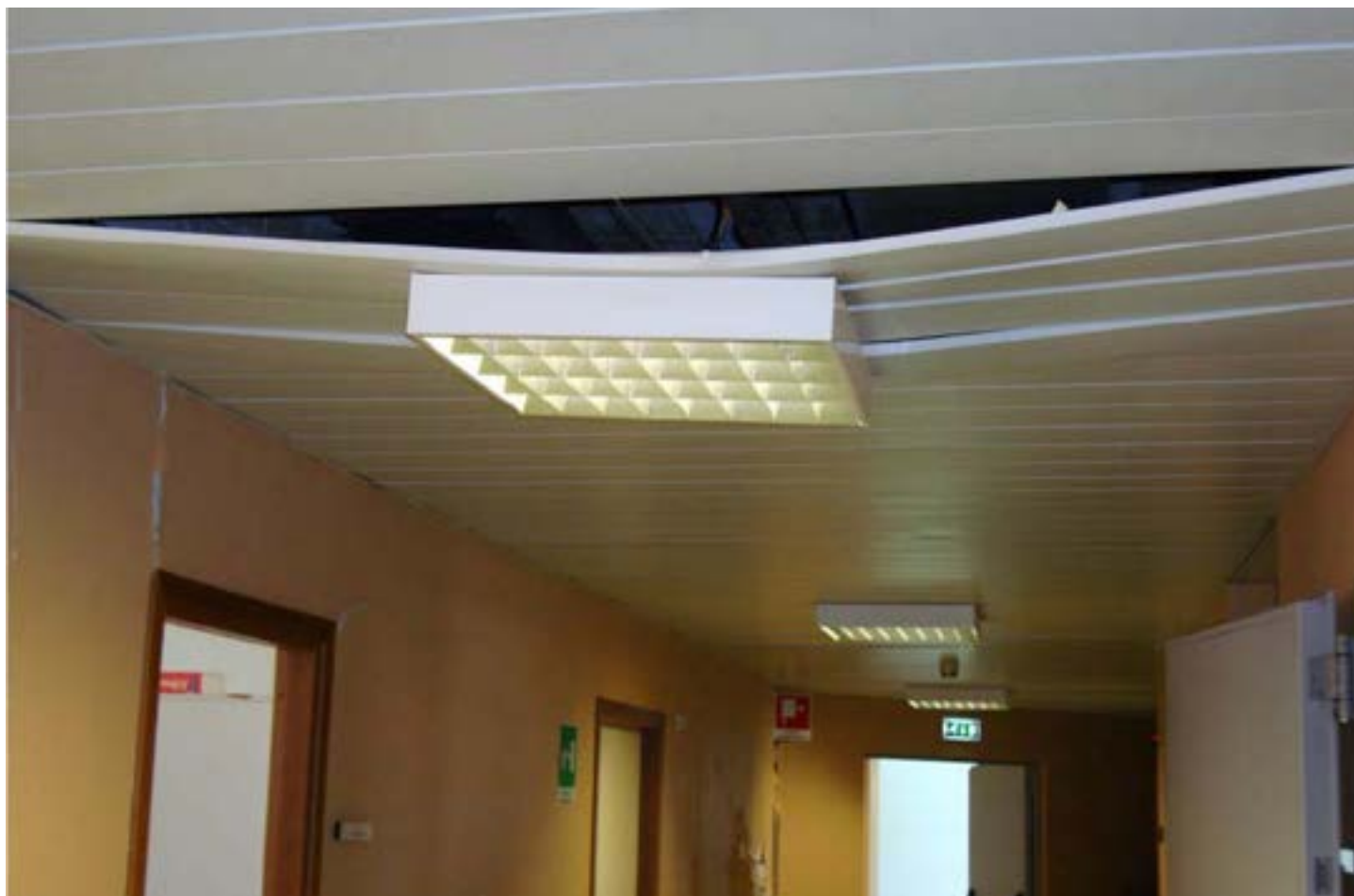
Ospedale San Salvatore dell'Aquila: controsoffitto a doghe in lamierino di acciaio
