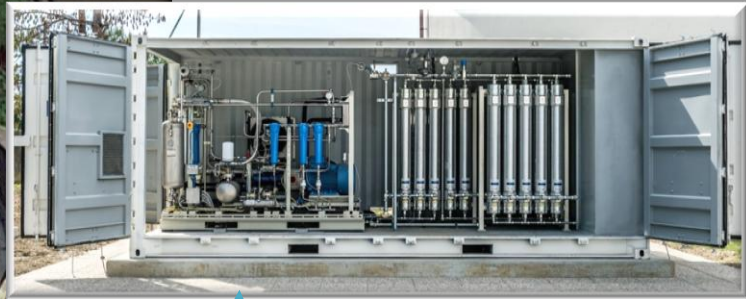
Impianto di upgrading (Membrane - SOL)
