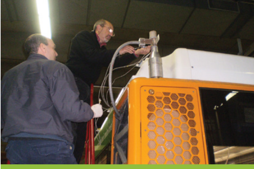
Installazione degli strumenti di misura delle emissioni gassose
