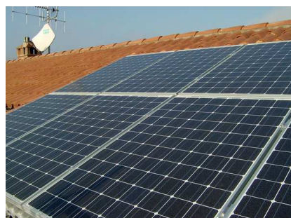
Impianto in silicio monocristallino su civile abitazione integrato nella copertura a coppi
