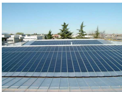
Impianto in silicio amorfo tecnologicamente innovativo con riqualificazione energetica
