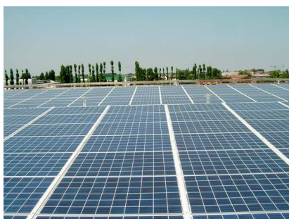
Impianto in silicio policristallino su edificio industriale
